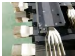
耐火型型母线槽
