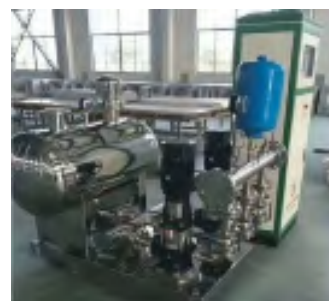
消防供水设备
